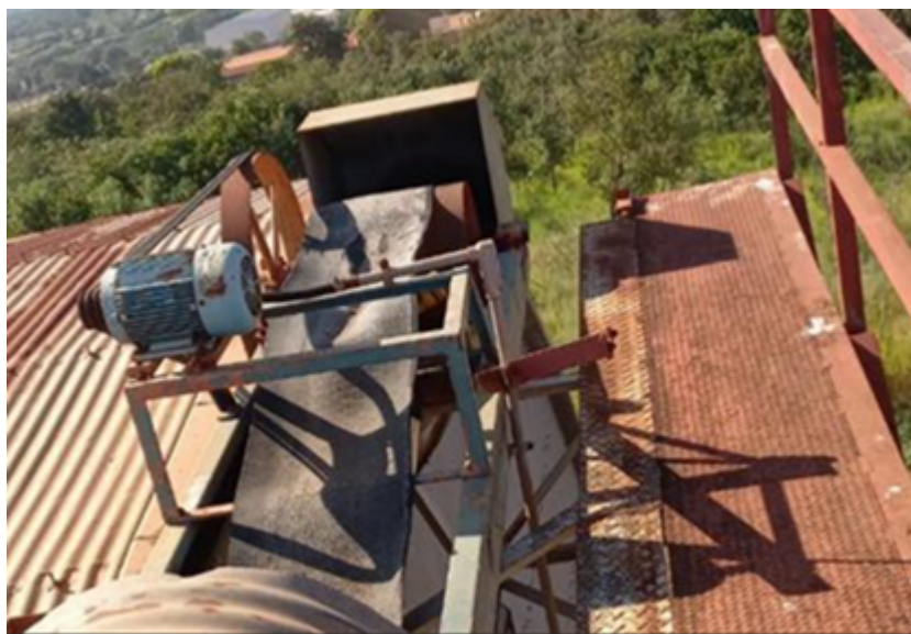
Correia que alimenta o graneleiro CODRASA nº 24. Vista do sistema de acionamento da correia.
