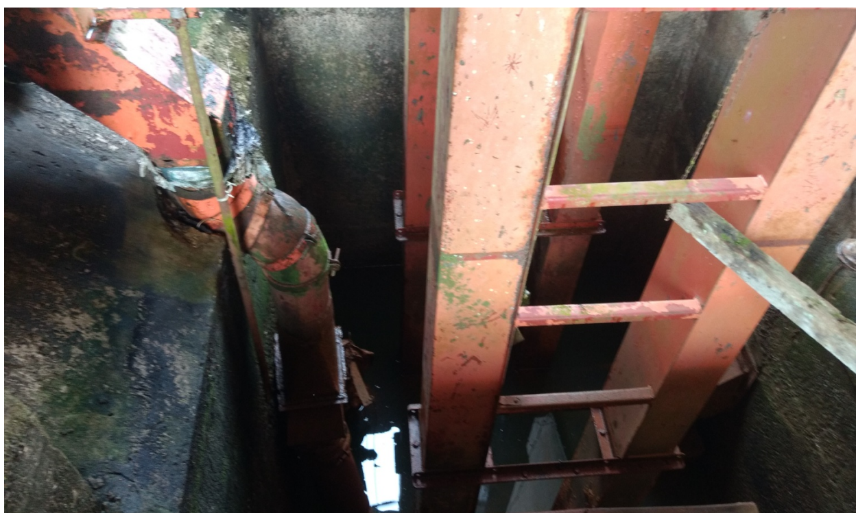
Foto 12 – Elevadores de grãos do sistema de processamento de grãos do armazém pré-moldado
