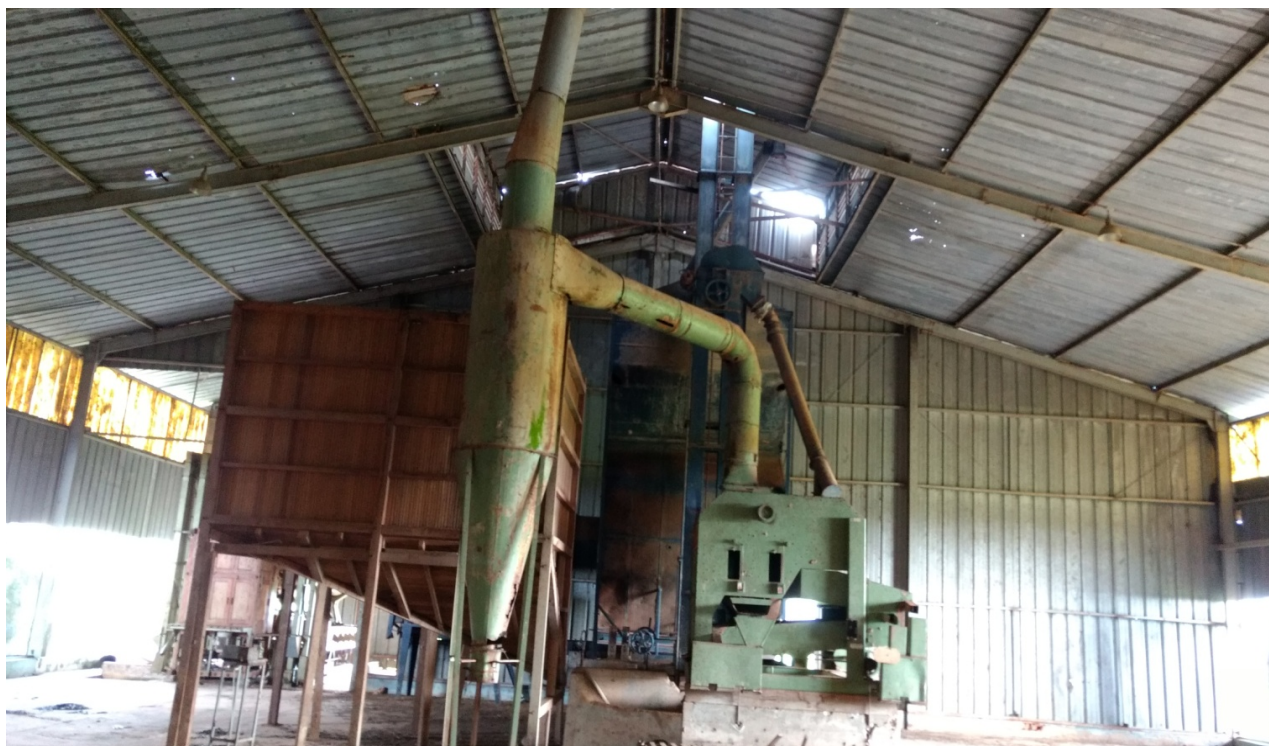
Foto 11 – Vista interna dos equipamentos de processamento de grãos do armazém metálico
