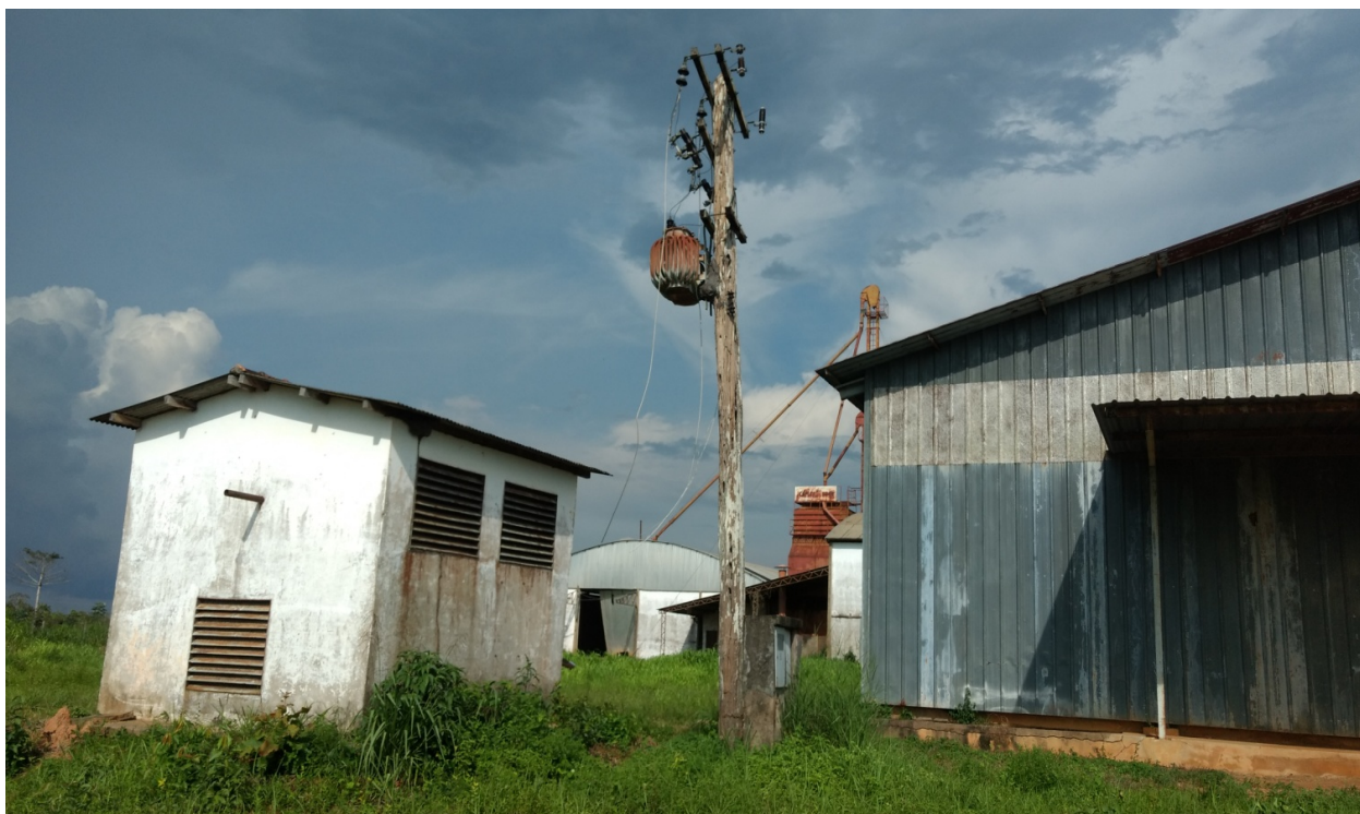
Foto 10– Vista do abrigo do grupo gerador de energia e do transformador de entrada
