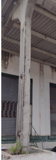
Figura 01: Exemplo de pilar com o recobrimento e armaduras avariados
