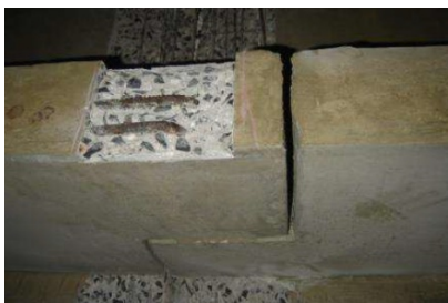
Figura 02: Exemplo de delimitação no concreto
