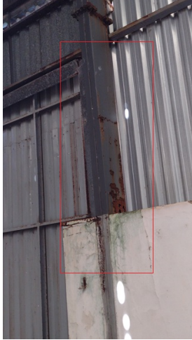
Figura 01: Exemplo de pilar oxidado no encontro com a alvenaria
