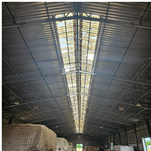
Figura 01: Foto interna do Sistema de Lanternim
