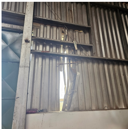
Figura 04: Fotos das telhas de fechamentos laterais danificadas
